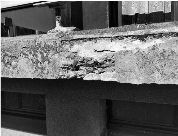
Photo 4.01-1. Épaufrement au niveau du nez de balcon
